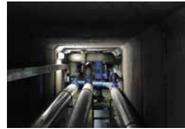
114_ V3lvules del dip3sit d'aig3es del parc de Can Werboom / V3lvulas del dep3sito de aguas del parque de Can Werboom / Storage tank valves at the Can Werboom waterpark / Chambre de vannes du r3servoir du parc de Can Werboom Premià de Mar Jorge Herrera
