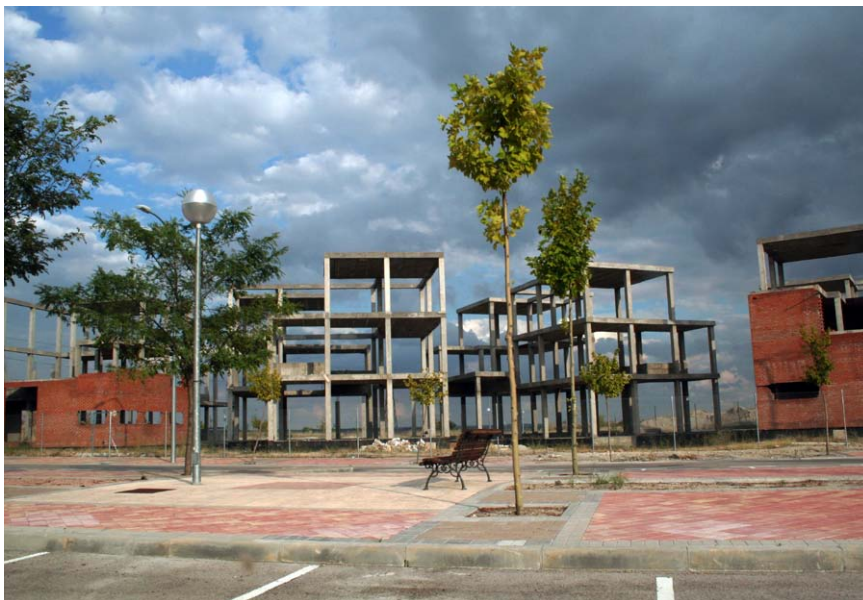
Imatge 10. Promoció d'habitatges abandonada.
