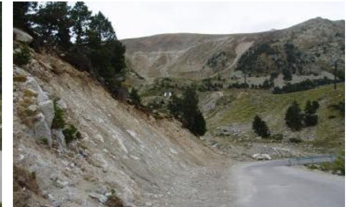
Talussos mal adequats de la carretera de Vallter 2000
