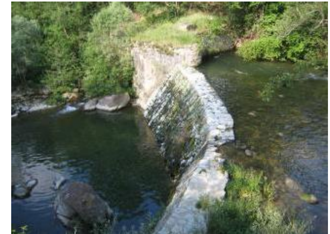
Resclosa vora Ter
