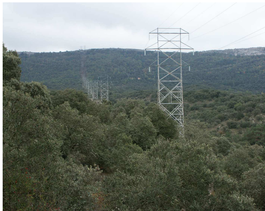
Figura 7.6. Vista parcial del traçat de la línia d'alta tensió situada al nord-oest d'Ulldemolins.
