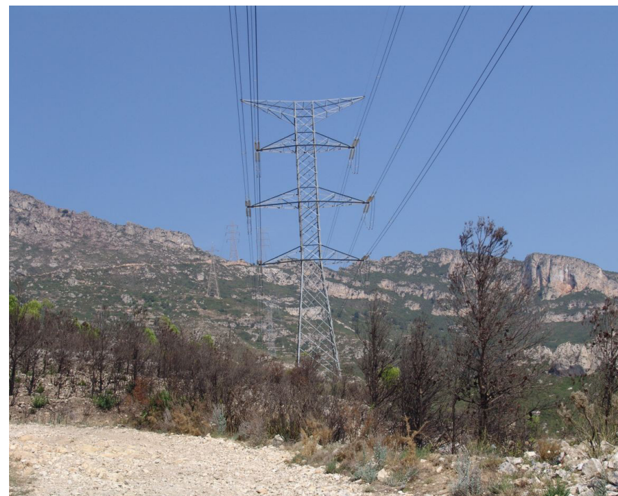
Figura 14.8. La necessitat d'evacuar l'energia generada a les centrals nuclears implica la presència de diverses línies d'Alta tensió que travessen la unitat.
