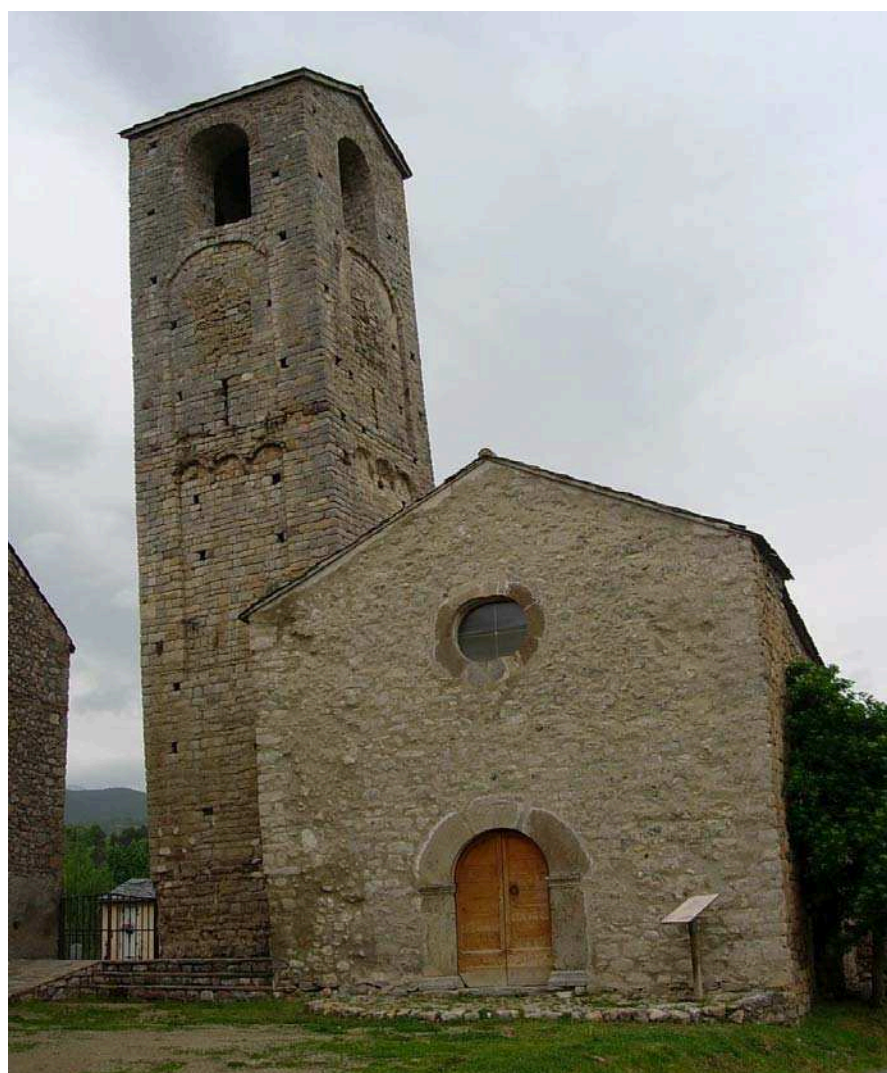
Figura 13.41: La inestabilitat dels terrenys propers a les falles que delimiten la plana cerdana ha fet que el campanar de Santa Eugènia de Nerellà presenti aquesta notable inclinació
