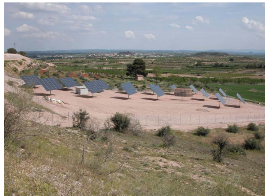
Figura 21.14. Parc solar al nord de Puiggròs (24.04.2006).
