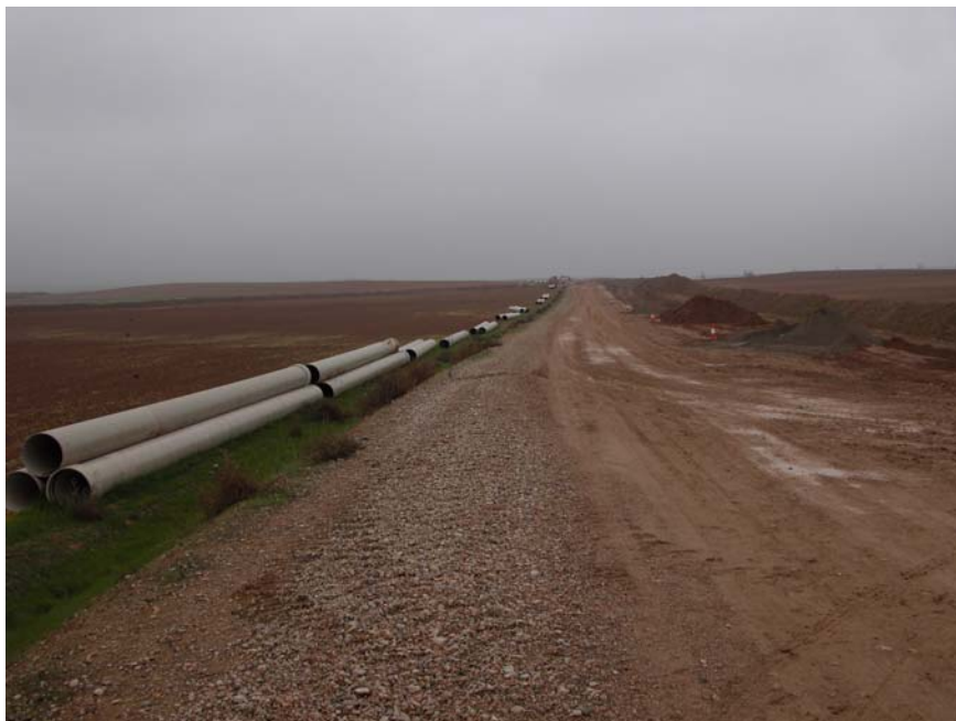
Figura 17.3. Obres d'ampliació de la zona regada pel canal Algerri-Balaguer, al camí d'Albesa a Castelló de Farfanya, ja al límit entre ambdós termes municipals (11.11.2005).
