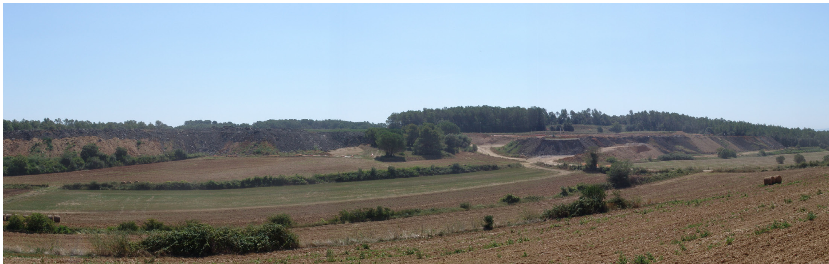
Figura 21.27: Talussos per a la construcció de la línia del TAV prop del nucli de Vilademuls.
