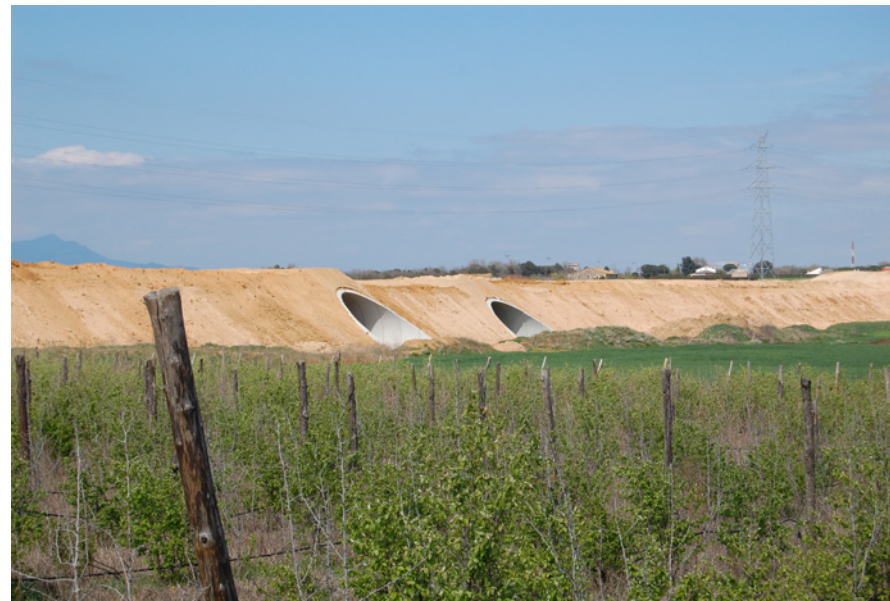
Figura 16.17: Obres de construcció de la línia del TAV a l'alçada de Riudellots.
