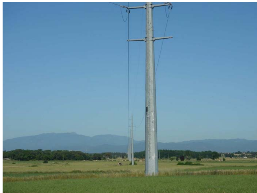
Figura 12.22: Fotografia d'una de les línies elèctriques al seu pas per la unitat.
