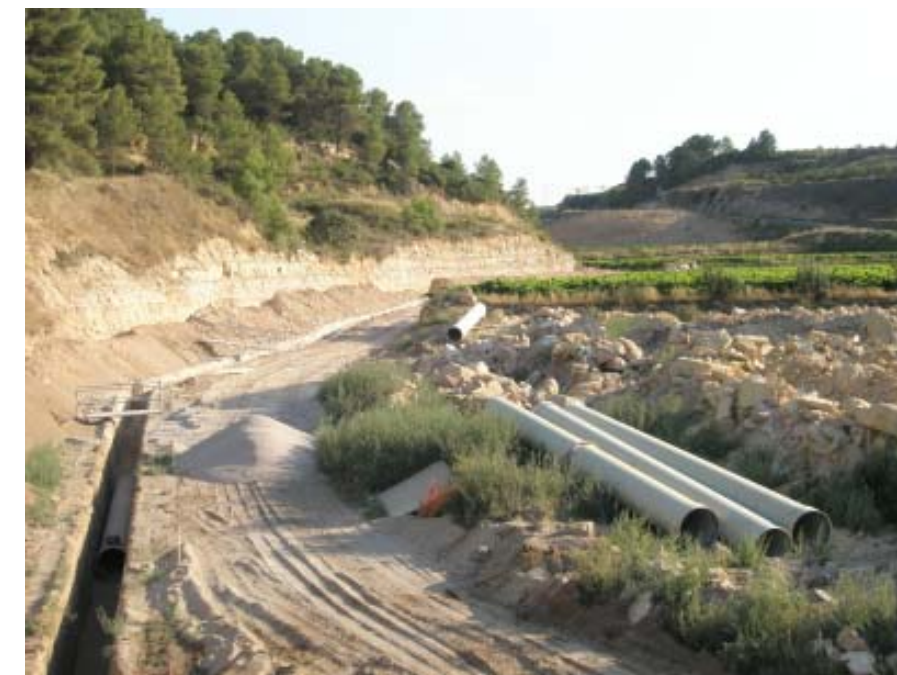
Figura 2.24. Obres de construcció del regadiu de la Terra Alta al terme municipal de Batea.
