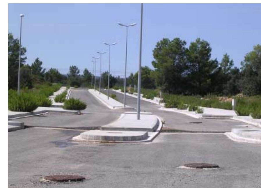
Figura 17.25. Urbanització inacabada i abandonada al terme municipal de l'Ametlla de Mar.
