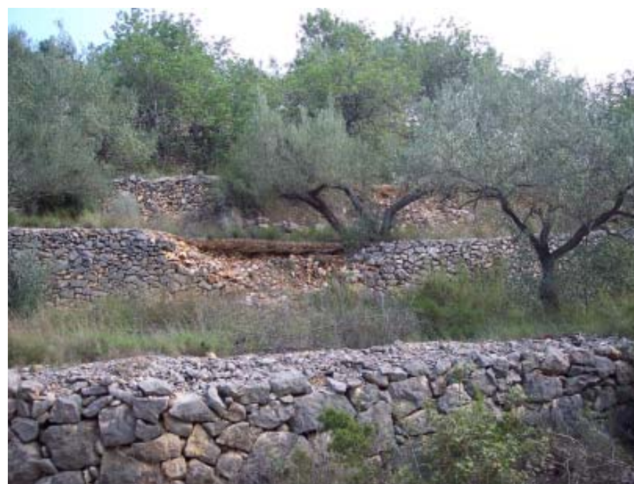
Figura 16.25. El procés d'abandonament del cultiu de secà en pendent, genera la pèrdua tant del patrimoni construït (a la imatge s'observa una solcida d'un marge), com de patrimoni agrari (en aquest cas, oliveres).
