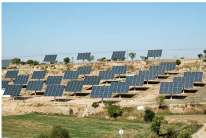
Parc solar pròxim al poble de les Oluges. Observatori del Paisatge
