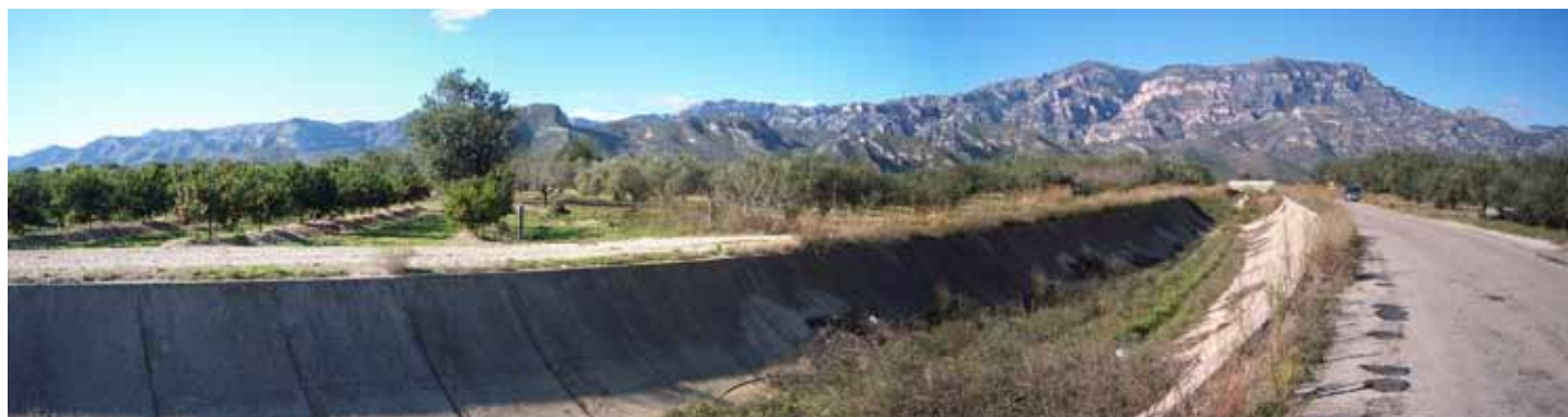
El traçat del nou canal Xerta-Sénia aprofita el de l'antic canal, construït fa més de tres dècades. Observatori del Paisatge
