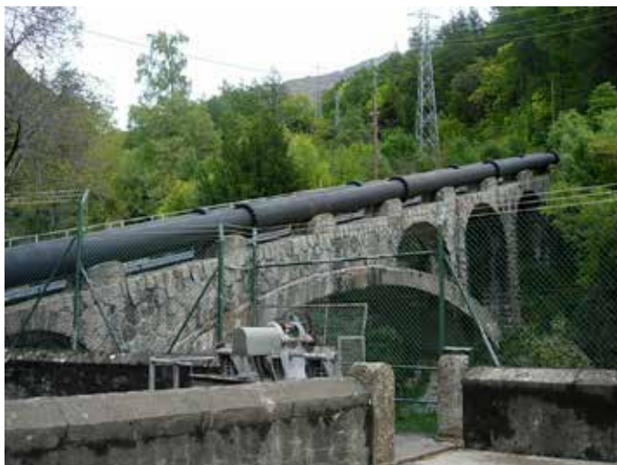
Canonada de pressió de la central hidroelèctrica de Capdella. El conjunt arquitectònic de la central s'ha convertit en un element de fort arrelament en el propi paisatge. Observatori del Paisatge
