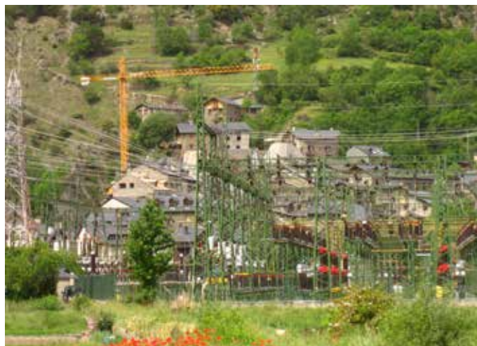
Les infraestructures elèctriques han alterat la imatge d'alguns nuclis de manera que, fins i tot, repercuteix en l'atractiu turístic. A la imatge, subestació elèctrica de Llavorsí, un punt neuràlgic del transport d'energia al Pirineu. Observatori del Paisatge
