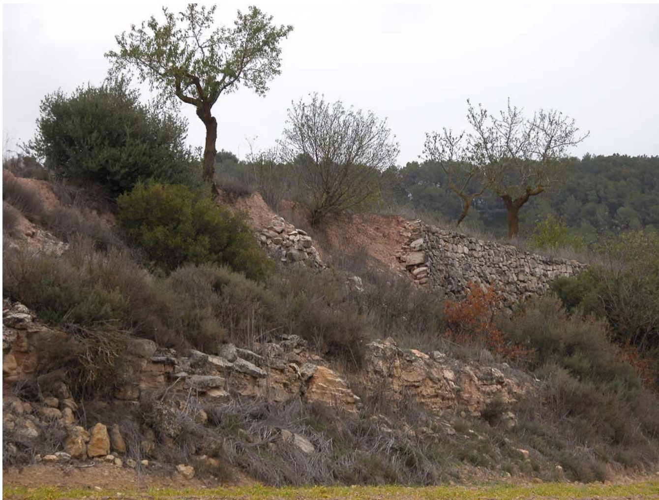
Fig. 4.3. Murs de pedra seca en mal estat de conservació a la vora d'Omells de na Gaia
