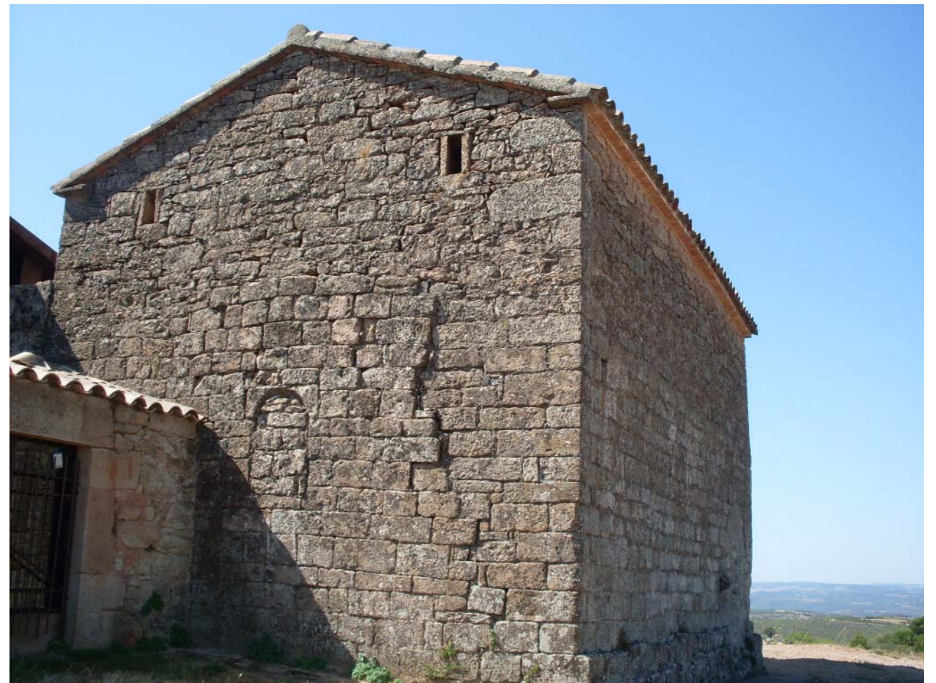
Figura 9.5 Mas a Perafita on pot apreciar-se la primitiva construcció sobre la que s'assenta la part superior.
