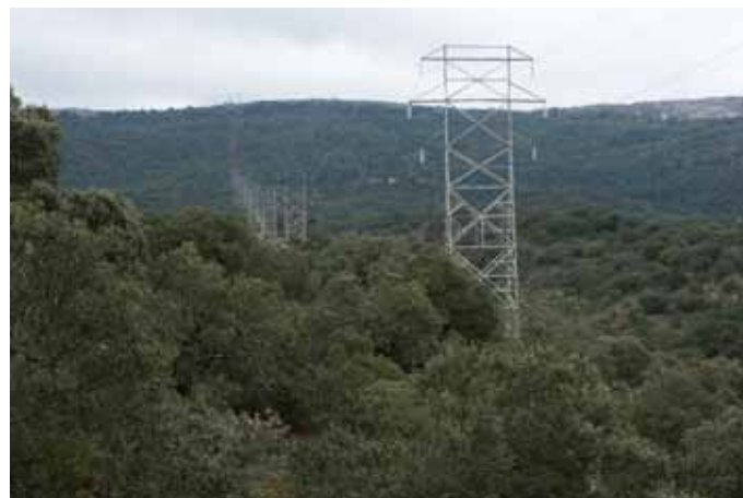
Vista parcial del traçat de la línia d'alta tensió situada al nord-oest d'Ulldemolins. Observatori del Paisatge
