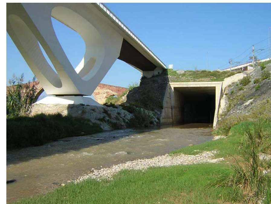
Figura 9.22: Per evitar els efectes catastròfics de les inundacions, i a mesura que s'han anat fent obres d'enginyeria diverses a l'àrea del congost del Cairat (nous ponts i talussos, canvis en la llera, etc.), s'han vehiculat mesures com l'eixidor del Llobregat, paral·lel al pont del Diable.
