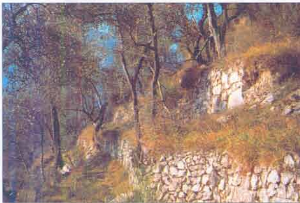
240. Murs de terrasses en mauvais état à Vésaire (Breil-sur-Roya, Praghio, aire B).
