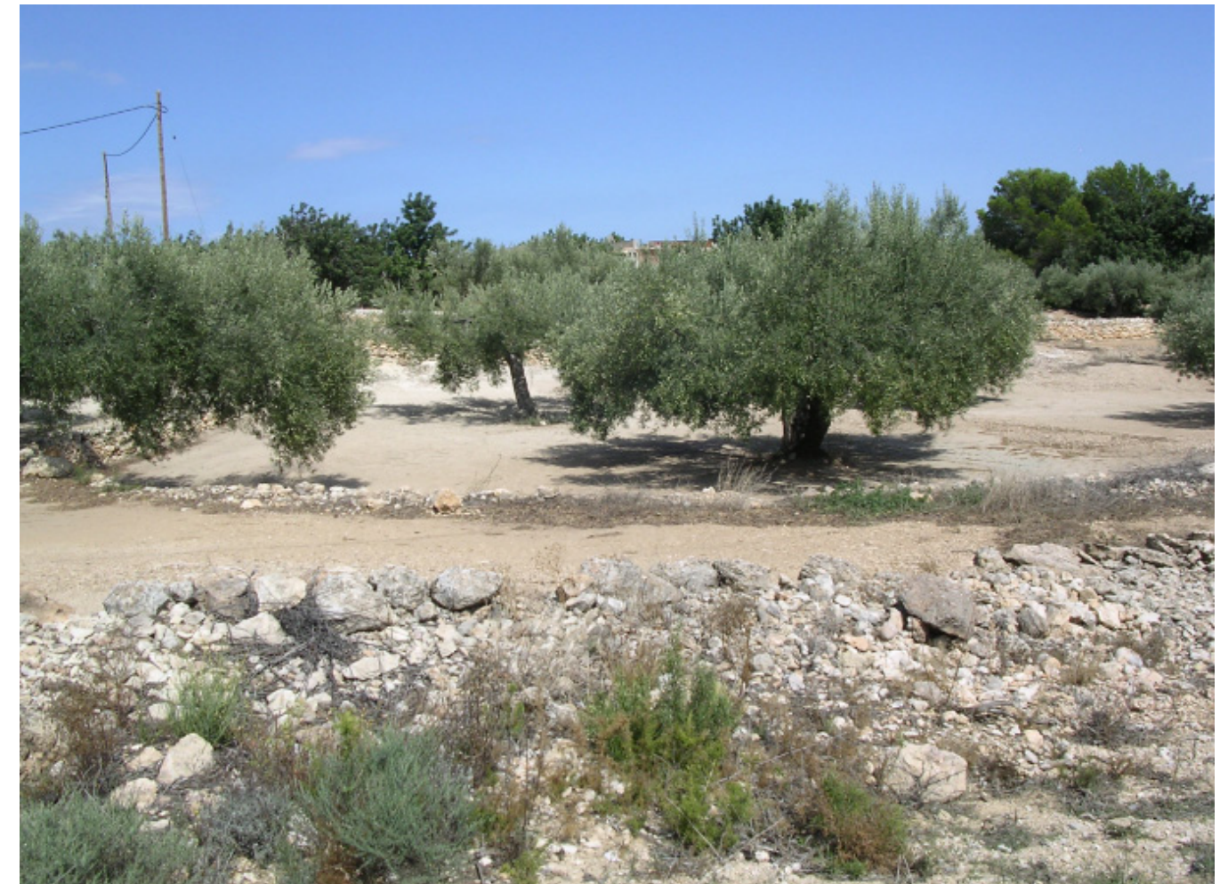
Figura 13.22. Murs de pedra en sec deteriorats.
