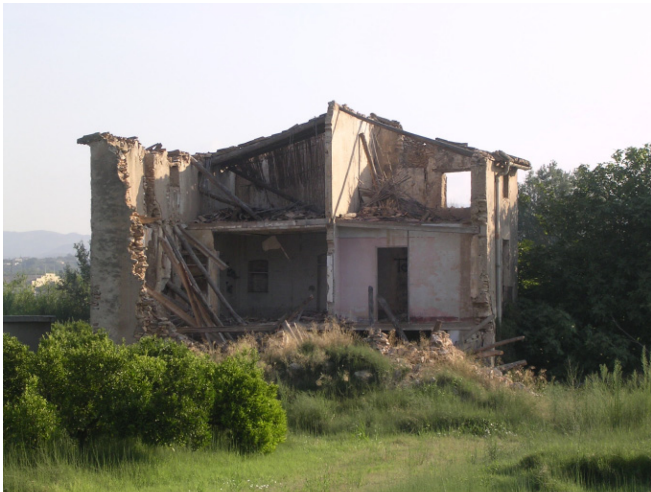
Figura 12.3. La degradació del patrimoni arquitectònic situat en l'entorn rural, es una de les debilitats de l'actual paisatge de les Terres de l'Ebre. A la imatge, mas abandonat a la vora de la carretera C-12, entre Amposta i Tortosa.
