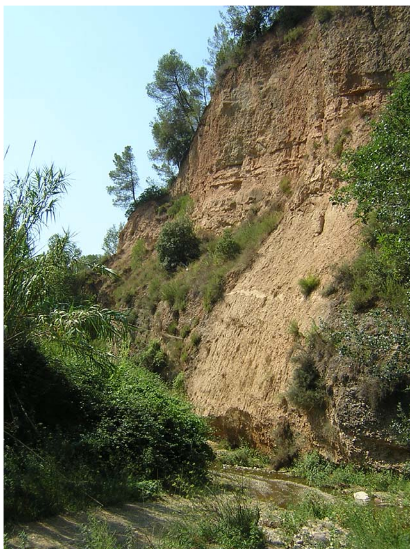
Figura 9.4: Xaragalls amb despreniment.
