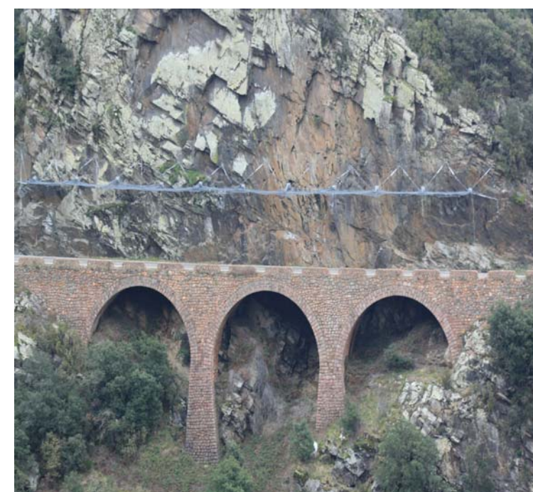
Figura 9.10 La seguretat d'alguns camins i carreteres cal reforçar-les amb mesures especials, com aquest cas a el Brull, Montseny.
