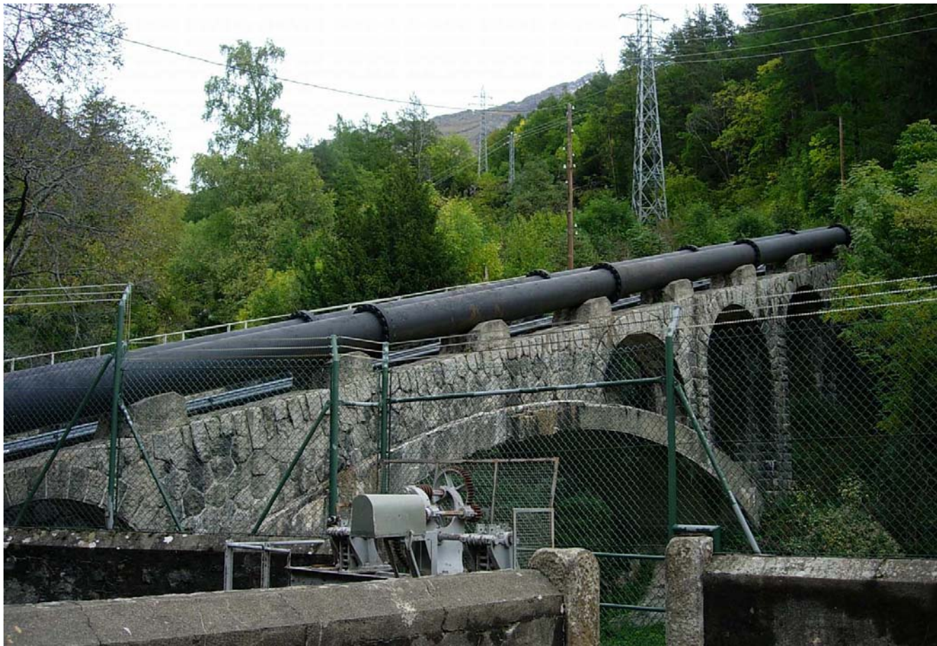
Figura 7.30. Canonada de pressió de la Central Hidroelèctrica de Cabdella. El conjunt arquitectònic de la central s'ha convertit en un element de fort arrelament en el propi paisatge
